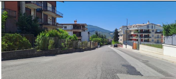
Foto 5: ammaloramento dell'asfalto Via Tuoro Cappuccini
